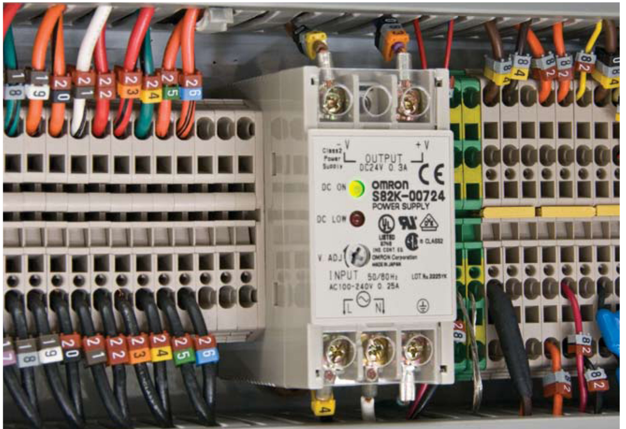
L'électronique de contrôle Omron de l'ensacheuse pour sacs de 10 kg.
